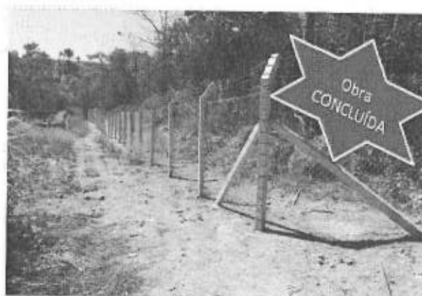
Execução do cercamento, via de acesso e barreira vegetal do Aterro Sanitário
